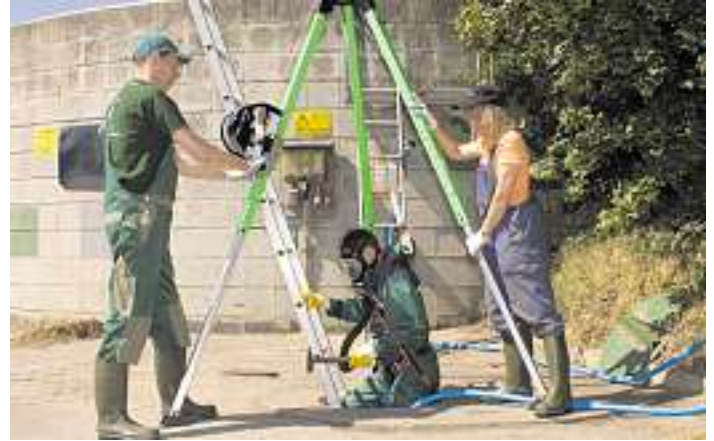
Einstieg ins Güllelager am Rettungsgurt mit einem umluftunabhängigen Frischluftgerät – gesichert durch zwei Personen.
